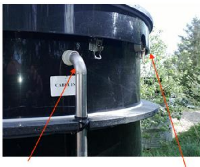
Kabelgenomföring till teknikenlådan
