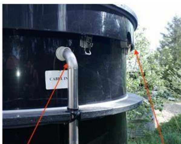
Kabelgenomföring till teknikenlådan
