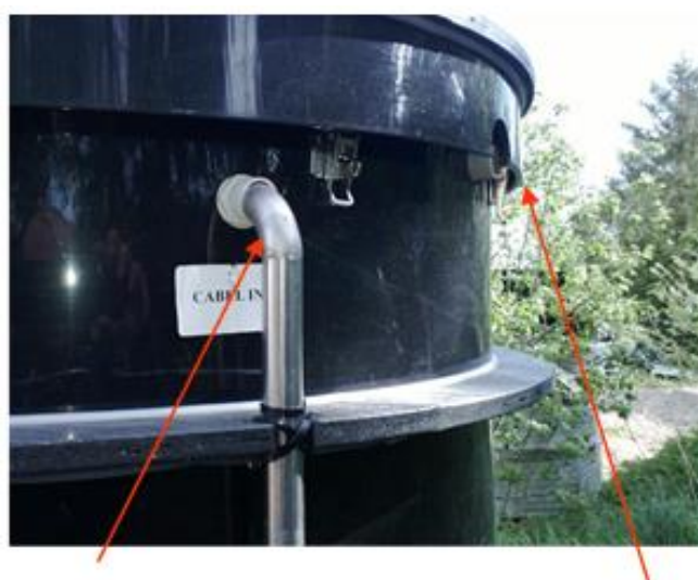
Kabelgenomföring till teknikenlådan
