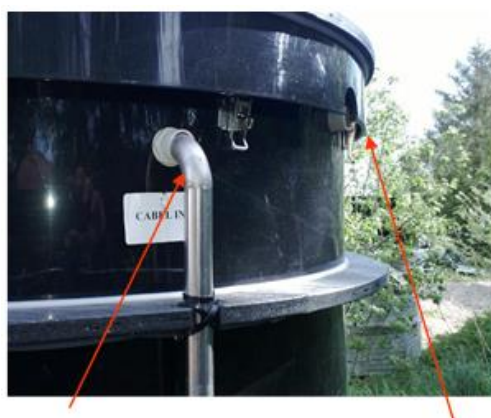
Kabelgenomföring till teknikenlådan
