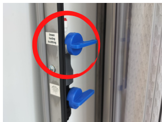
Luftningskran på enheten
