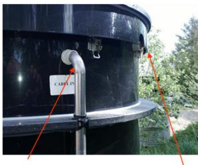
Kabelgenomföring till teknikenlådan
